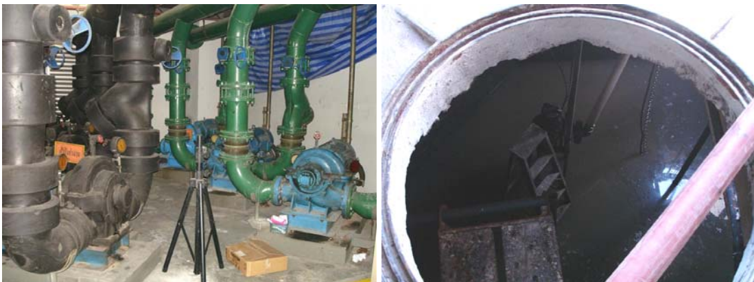
รูปที่ 2.3.13 แสดงปั้มน้ำประปา (Water Pump) และปั้มระบบบำบัดน้ำเสีย (Sanitary Pump)
