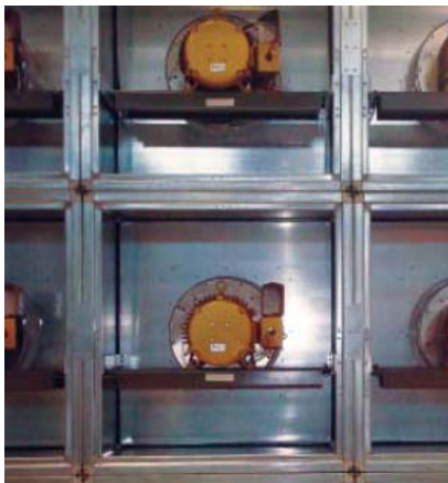
รูปที่ 4.2.4 ชุดพัดลม Exhaust Air ใน “Fan Wall” (18ชุด)
