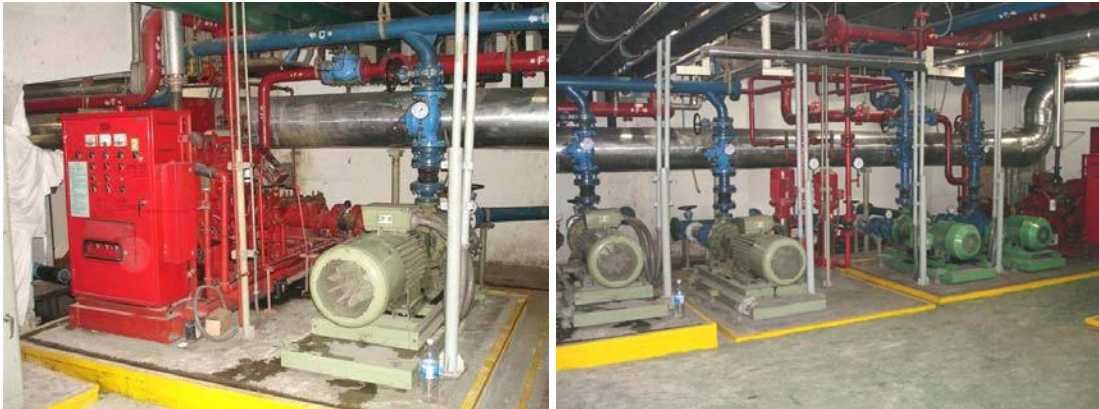
รูปที่ 2.3.12 แสดงปั้มน้ำดับเพลิง (Fire Pump) และปั้มปรับแรงดันในระบบท่อดับเพลิง (Jockey Pump)
